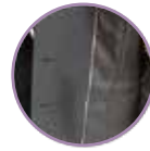
内側のパイピング
